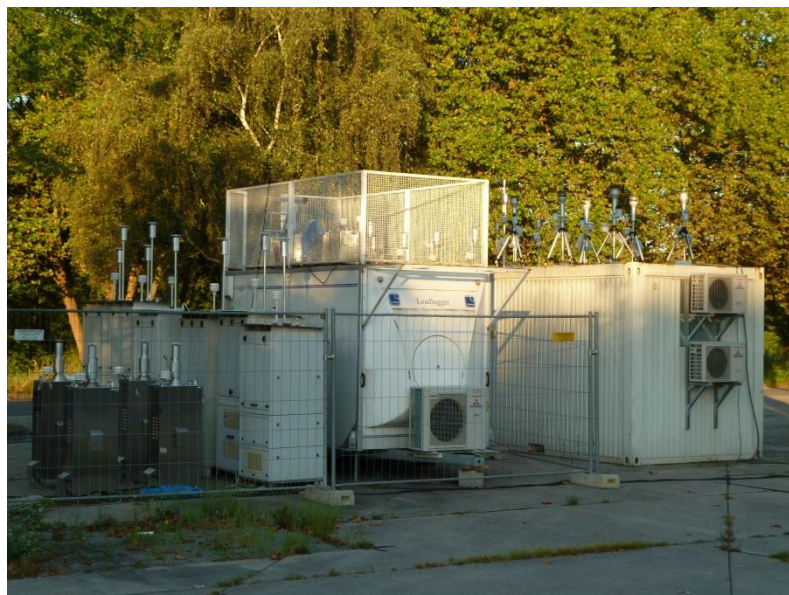
Abbildung 38: Feldteststandort Bornheim, Referenzgeräte (LVS 3) installiert im mittleren Trailer
